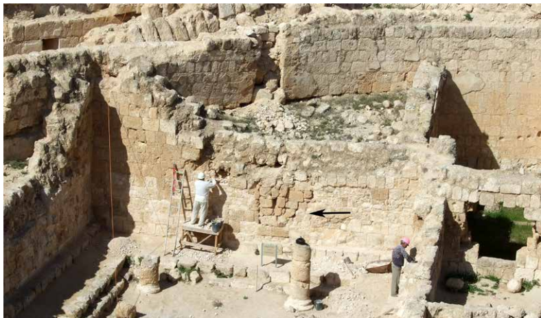
איור 19: הקיר המערבי של בית הכנסת והפתח הסתום בו במהלך עבודות השימור בשנת 2008
